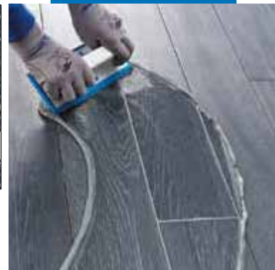
Разстилане на Kerapoxy Design върху подови гранитогресни плочки с ефект на дърво с гумена пердашка
